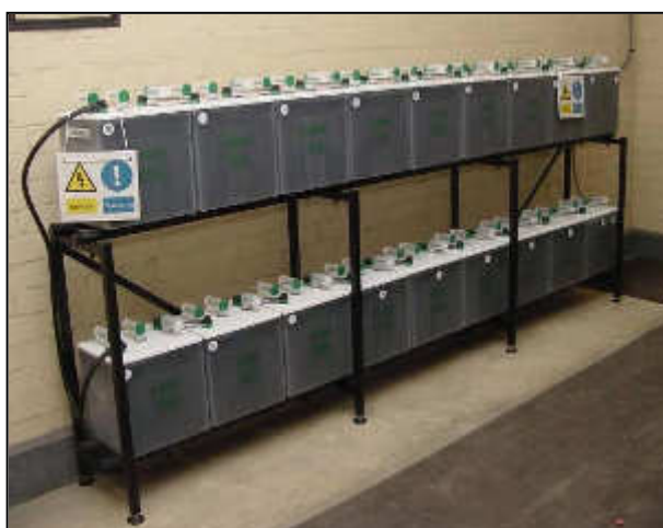
Figura 2.21 - Banco de baterias. Fonte: Voltec Engenharia, 2016.
